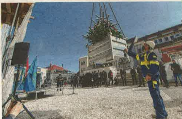
Az épülő új szárnyban múzeum-pedagógia termet, gyermekfoglalkoztatót, konferenciatermet, ajándékboltot, raktárakat és restaurátorműhelyeket alakítanak ki
