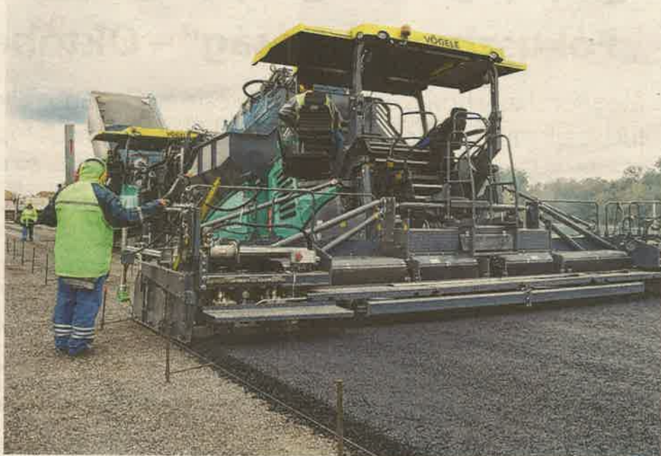
A dinamikus felület korábban kapott egy szőtt geotextíliát, arra 80 centiméter vastagságúra betömörített bazaltalap került. Erre terítik a gépek a 12 centiméter vastagságú aszfaltot, amit 10 centisre egyengetnek a munkálatok során
