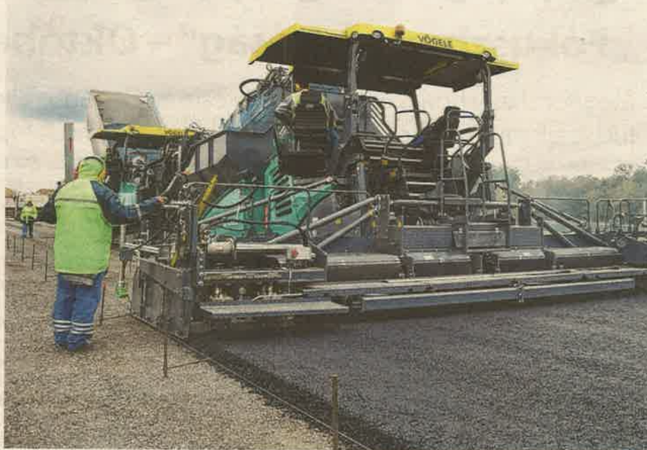
A dinamikus felület korábban kapott egy szőtt geotextíliát, arra 80 centiméter vastagságúra betömörített bazaltalapot került. Erre terítik a gépek a 12 centiméter vastagságú aszfaltot, amit 10 centisre egyengetnek a munkálatok során
